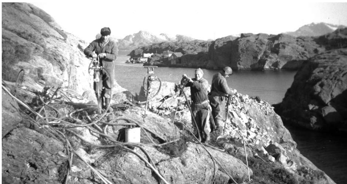
Vegbygging ved Nára kring 1965. Her er karane endeleg komne så langt austover på Ytre Sula at dei ser enden. Dei er i sving med borehamrane i bakken ned mot sjøen, berre eit par hundre meter frå der ferjeleiet skal ligge. Til venstre ser vi litt av dampskipskaia og handelsstaden Nára. Foto: Jørgen Nesheim
